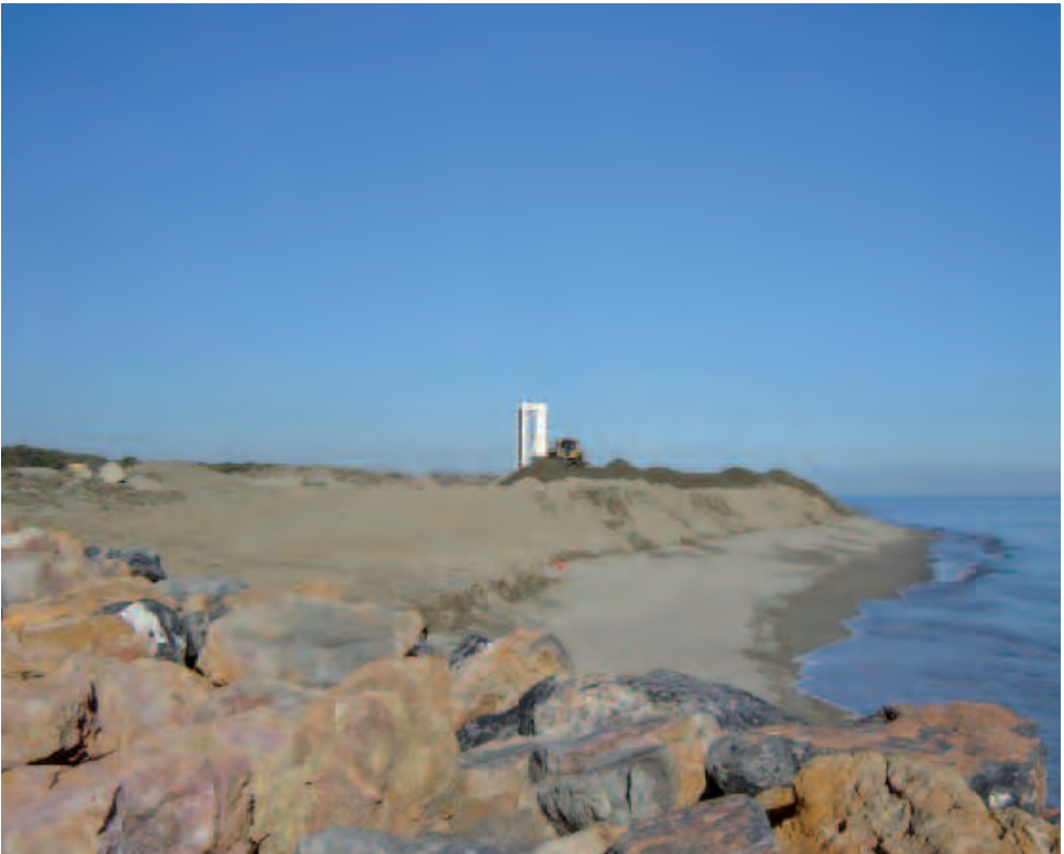
Photo A.9 Travaux de régalaage des 60 000 m 3 de sables amenés par charrois suite à l'extension du port de Canet en Roussillon. © EID Méditerranée
