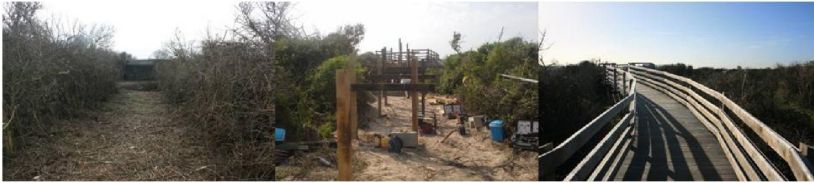
Vues de différentes phases de création de la rampe nord, d'accès au sommet du blockhaus, prises en pied de chantier. A gauche ouverture dans la végétation, au centre pose des poutres de soutènements, à droite rampe achevée. (RNNPO/EDEN62 - A.D.)
