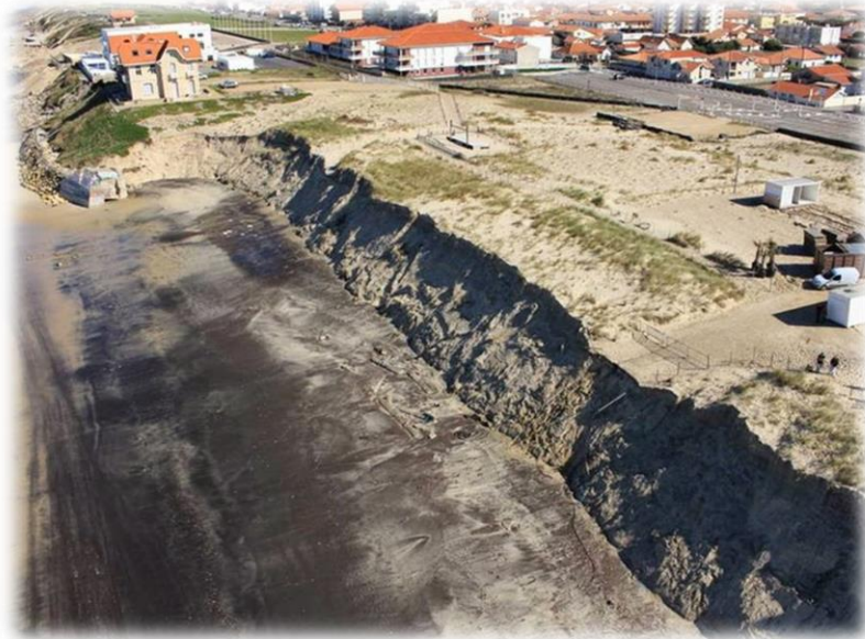
Photo 4 : situation de la dune en aval-dérive des bâtiments de première ligne après l'hiver 2013/2014. Des bâtiments très exposés et des enrochements accélérateurs d'érosion de part et d'autre – Source : © SPAD 2014 (non libre de droit)
