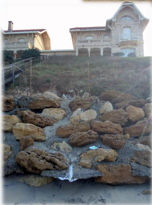
Photo 8 : les deux villas jumelles, copropriétés regroupant respectivement 14 et 8 appartements, sont situées au sommet d'une dune sur un trait de côte de plus en plus soumis au risque érosion. Les enrochements délabrés, datant des années 80, permettent de constater, la variation très importante de l'altitude de plage, à laquelle ils contribuent, 4 mars 2021 ©CCGL
