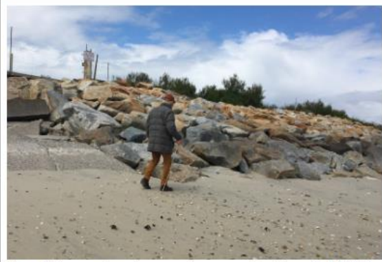
Ces digues classées remises en gestion à AQTA posent de lourdes questions de coût et de techniques d'entretien... (photo JF)
