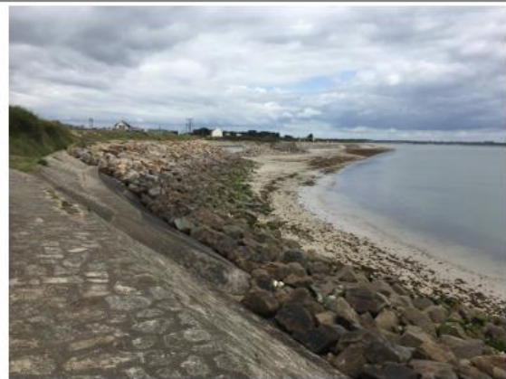
Sur une grande partie de la face est de l'isthme de Penthièvre des ouvrages de défense « dure » posent des questions d'efficacité dans le long terme... (photo Jean Favennec)
