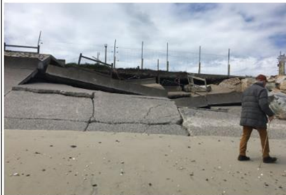
Effondrement de la digue... Est-il judicieux de continuer à réparer au coup par coup ces dégradations ? (photo JF)
