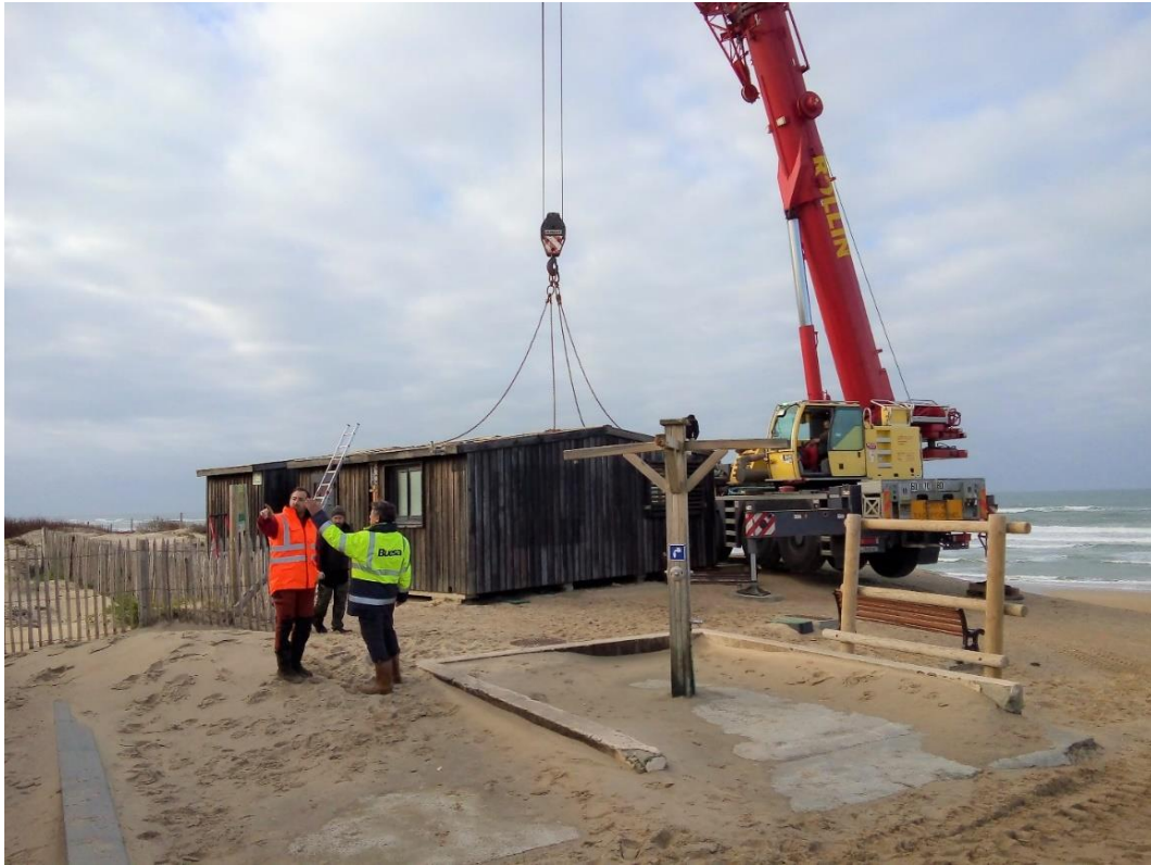
Document 3 : photo du retrait nécessaire (une première !) du poste de secours MNS (maître-nageur sauveteur) suite à la tempête Bella (27-29/12/2020) ©CdC des Grands Lacs, Biscarrosse (40) le 15 janvier 2021
