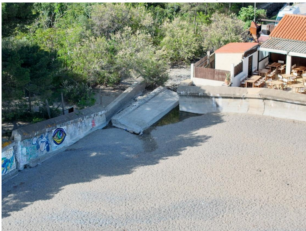
Sur la plage de l'usine, l'ouvrage marque des signes d'instabilité ponctuels.
